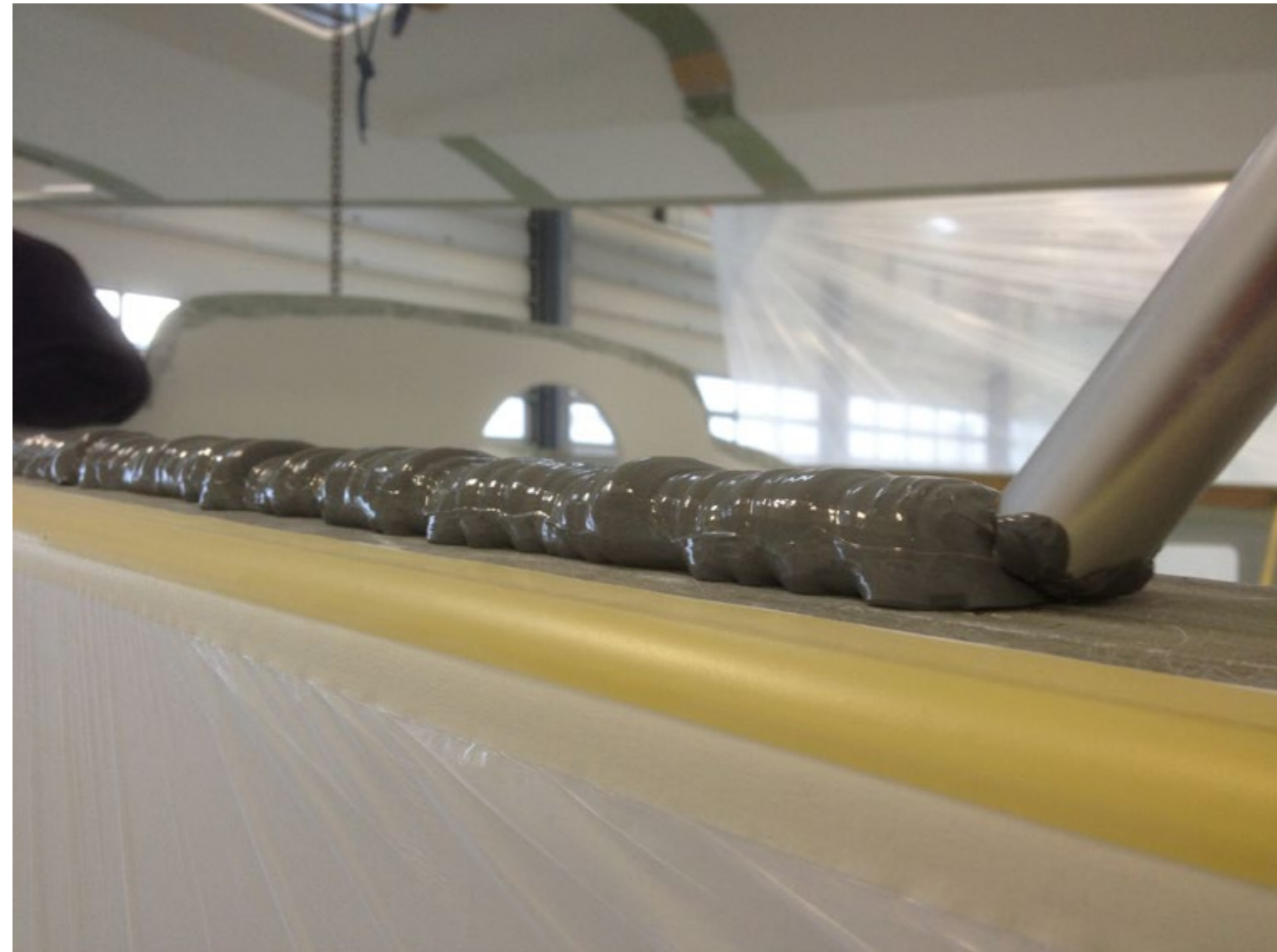
Dépose d'Adekit A236 sur la coque. Jusqu'à 5 kg/minute avec un équipement de dosage standard
